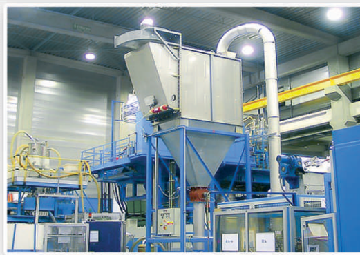
- Coletora de pó na fábrica de tanques de carro
